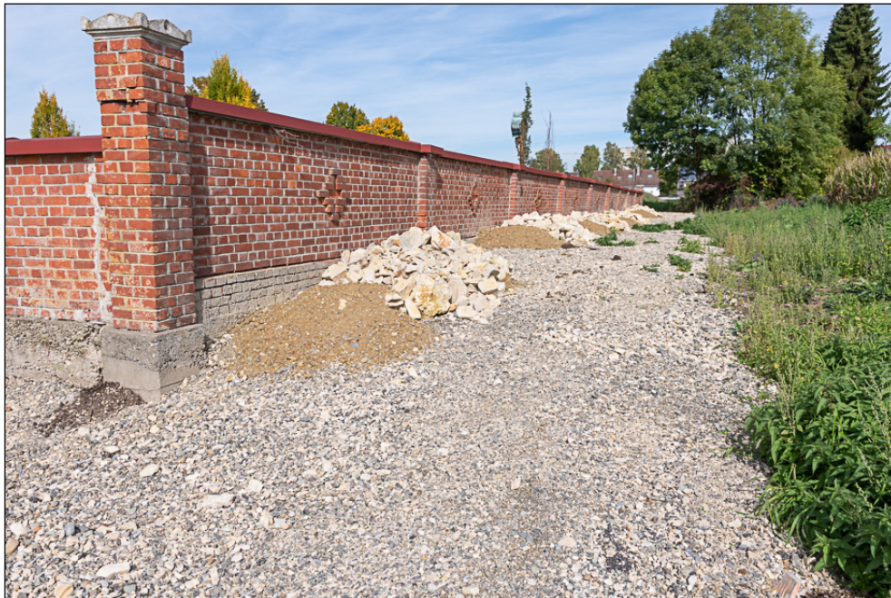
Abb. 11: Friedhofmauer Ost – Istzustand am 04.10.2022
